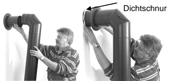
Abb. 17: Anschluss Rauchrohr am Schornstein
