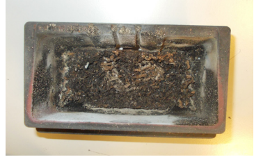
BEISPIEL VERSCHMUTZTE BRENNSCHALE
