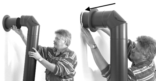
Abb. 19: Anschluss Rauchrohr am Schornstein
