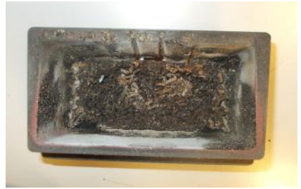
BEISPIEL VERSCHMUTZTE BRENNSCHALE
